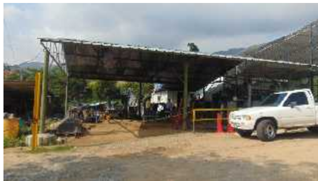
Lugar de ubicación de los equipos K 7 Via Giron-Lebrija Intercambiador Fenix
